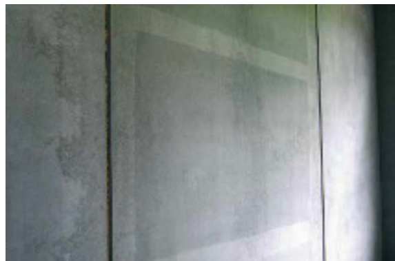
Abb. 4.6 Verfärbungen durch Überdosierung des Trennmittels
