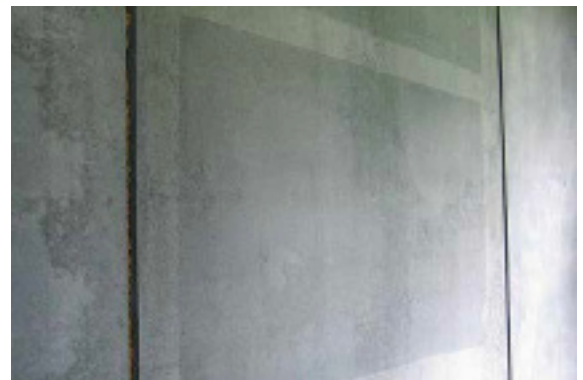
Abb. 5.6 Farbunterschiede verursacht durch
