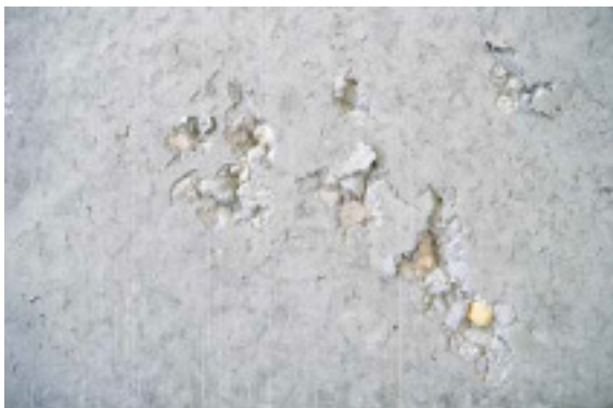
Abb. 4.7 Abplatzungen an der Betonoberfläche
