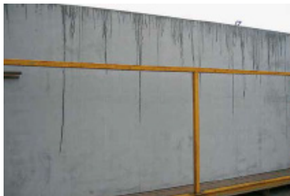
Rys. 5.4 Nieosłonięte składowanie: ślady po wodzie
