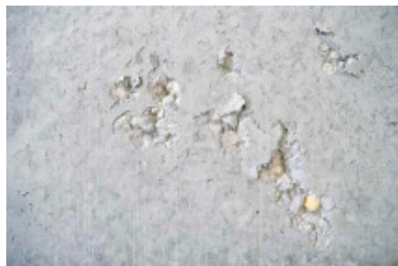
Rys. 4.7 Oderwania na powierzchni betonu
