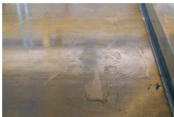
Rys. 4.3 Uwaga, ślady stóp pozostają widoczne
