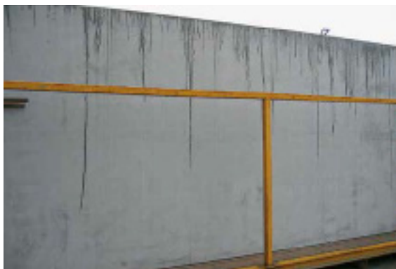
Obr. 5.4 Nechránené skladovanie: stopy po vode
