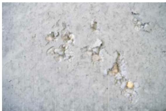
Obr. 4.7 Odtrhnutia na povrchu betónu
